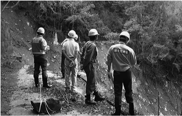
村道池郷線 路体崩壊
