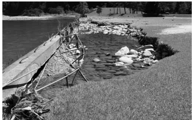
池郷川対岸グラウンド 浸水・土砂流入・洗堀
