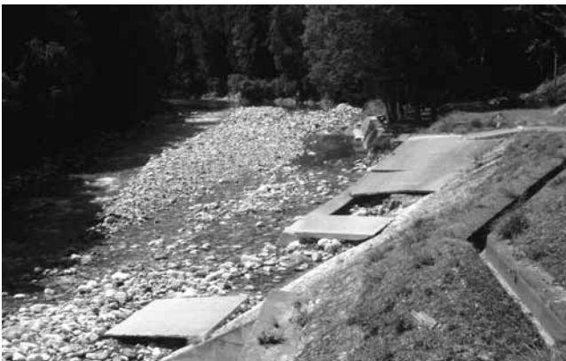
浦向(道須)消防道路損壊
