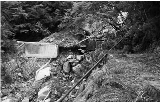
備後川林道 路体崩壊
